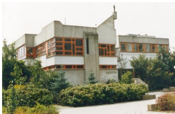
Gemeindezentrum Mitte in den 90er Jahren. Bereits deutlich erkennbar sind die Schäden an der Fassade wegen fehlender Abdeckungen an Betonkanten und Vorsprüngen
